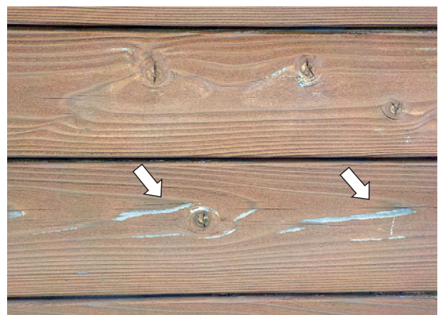
図6 浸透型塗料の塗布後8年6カ月経過時 (矢印：塗料の抜け落ち)
