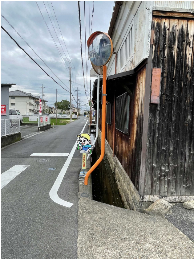
⑩ 水路に蓋がない
