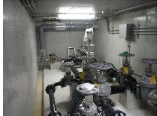
流量計室内配管状況
