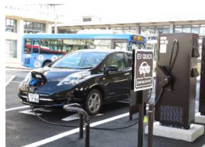
急速充電設備（県本庁舎）
