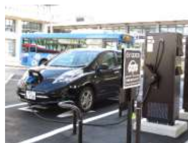
急速充電設備 (県本庁舎)
