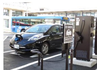
急速充電設備（県本庁舎）
