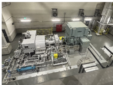
蒸気タービンと発電機
