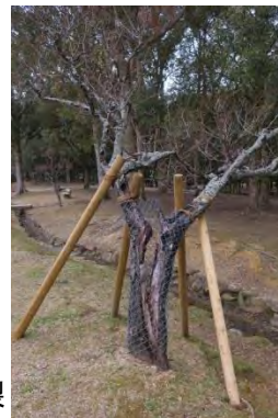
幹の腐朽・断裂
