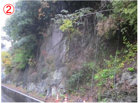
岩盤崩落の危険性が高い箇所
