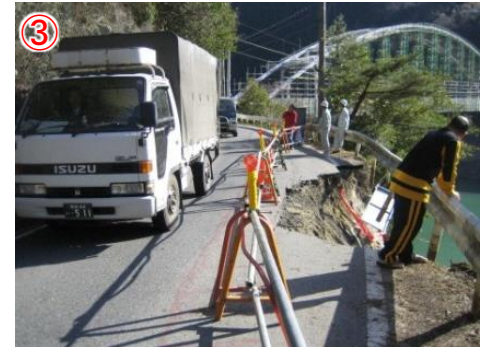
路肩決壊状況 (H18.3.13発生)
