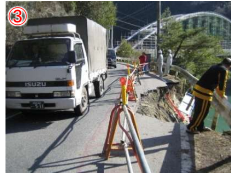
③ 路肩決壊状況(H18.3.13発生)
