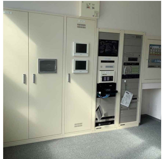
事務室 (各種操作盤)
