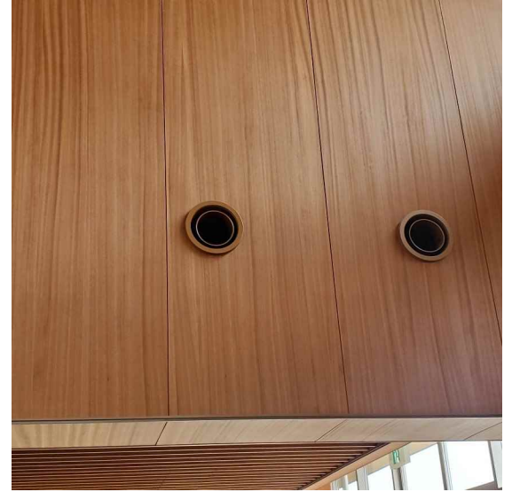
空調屋内機（吹出し口）
