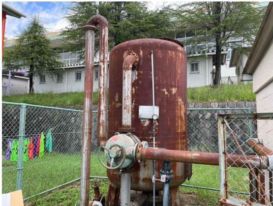
ろ過器（施工前）
