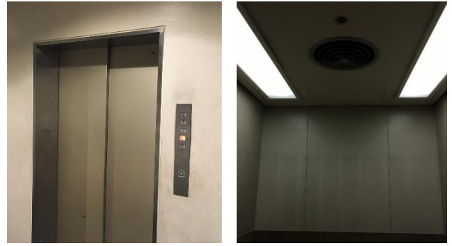
図－ 7． 事務所エレベーターの例
