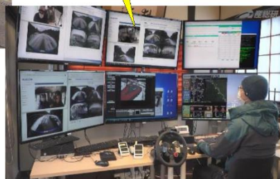
遠隔監視・操作室
