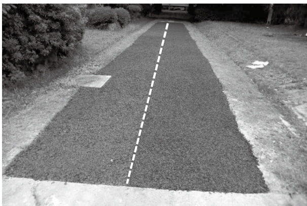
図2 施工直後の木質舗装材 (左:無処理チップ舗装、右:処理チップ舗装 撮影日:2008.9.25)
