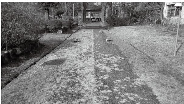
図3 施工後12年が経過した木質舗装材 (左:無処理チップ舗装、右:処理チップ舗装 撮影日:2021.1.26)
