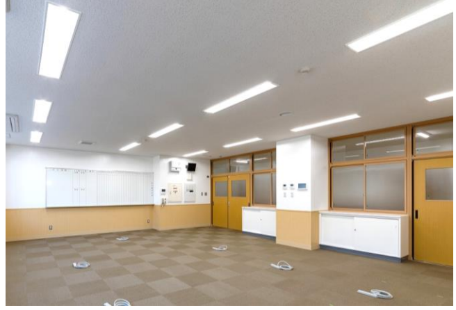
照明設備 (職員室)
