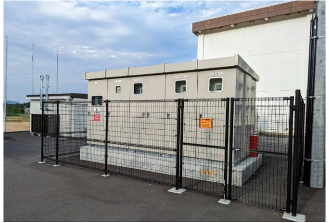
受変電設備 (施工後)
