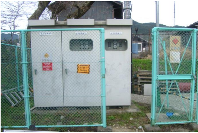
受変電設備 (施工前)
