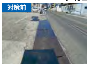
段差があり、高齢者等の通行に支障
