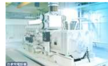
写真出典:建築物における電気設備の浸水対策 のあり方に関する検討会(第3回) 参考資料3(国土交通省HP)
