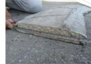
落下したモルタル
