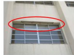
外壁の下端のモルタルが落下
