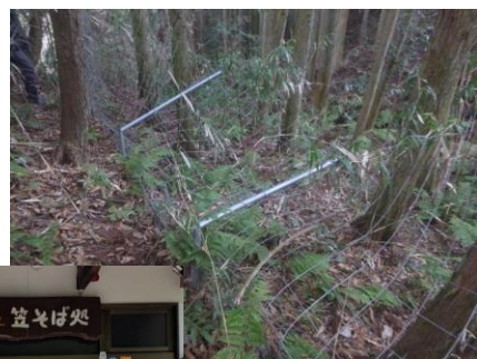
破損した防護柵
