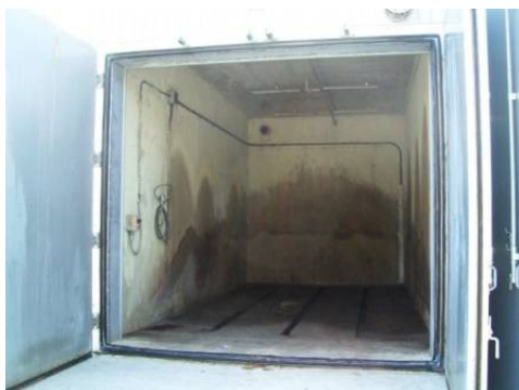
図1 乾式メタン発酵槽
