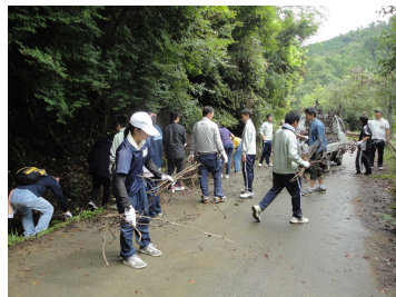
側溝から倒木を取り除く
