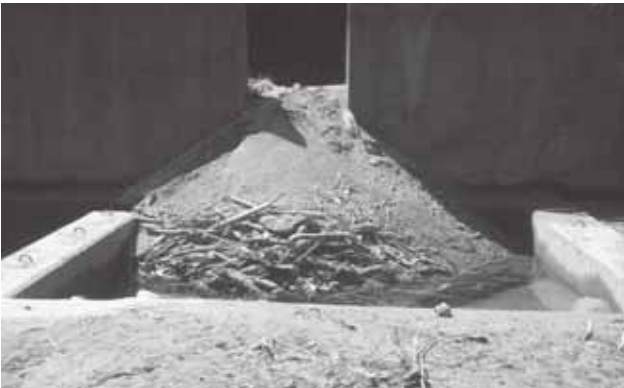
写真 62 平成 23 年 9 月 8 日 採捕施設蓄養池への土砂流入（下北山村）
