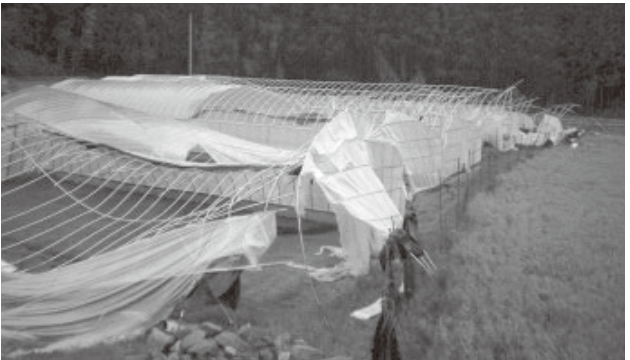
写真 46 平成 23 年 9 月 5 日 パイプハウス倒壊の状況 (曾爾村)
