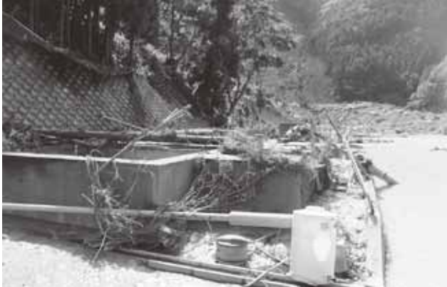
写真 40 水道施設(ろ過槽)の被害状況
