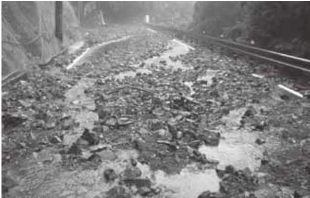
写真 3 国道 168 号（路面全面に土砂が流出）
