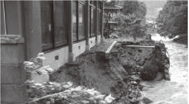
写真 24 平成23年9月15日 室生川被災状況
