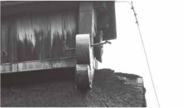
写真 68 金峯山寺檜皮葺屋根一部破損状況
