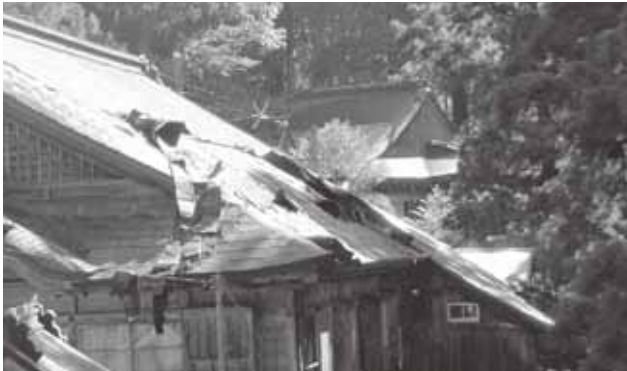
写真 67 玉置神社社務所及び台所屋根破損状況
