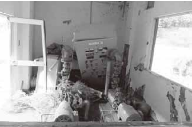
写真 39 水道施設(ポンプ室)の被害状況
