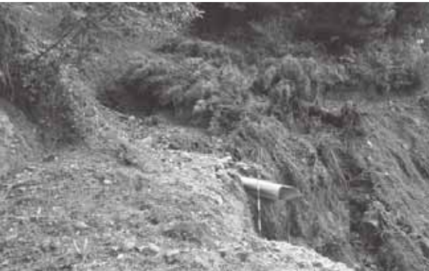
写真 58 平成 23 年 9 月 28 日 古瀬谷線の崩壊（野迫川村上地区）
