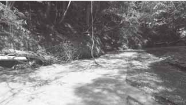
写真 60 平成 23 年 9 月 12 日 養魚施設導水管の破損（十津川村）
