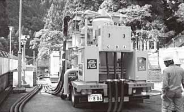
写真 35 平成 23 年 9 月 20 日 移動用変圧器車
