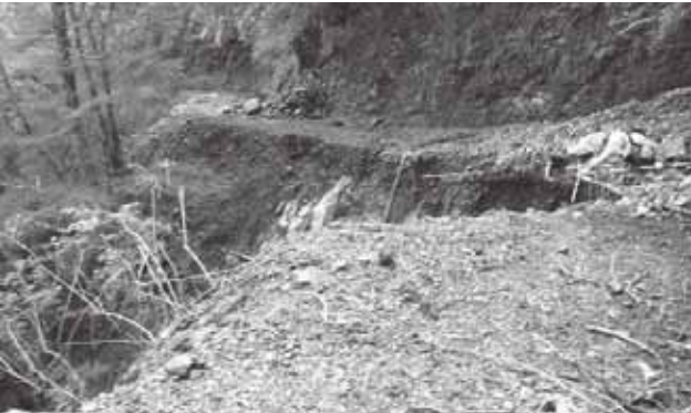
写真 57 平成 23 年 9 月 27 日 下向山線の崩壊（野迫川村平地区）
