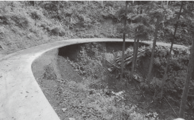
写真 56 平成 23 年 9 月 26 日 辻合峯線の崩壊（野迫川村松股地区）
