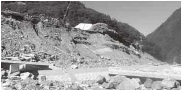
写真 25 平成23年10月6日 護岸被災状況（十津川村七色地区）
