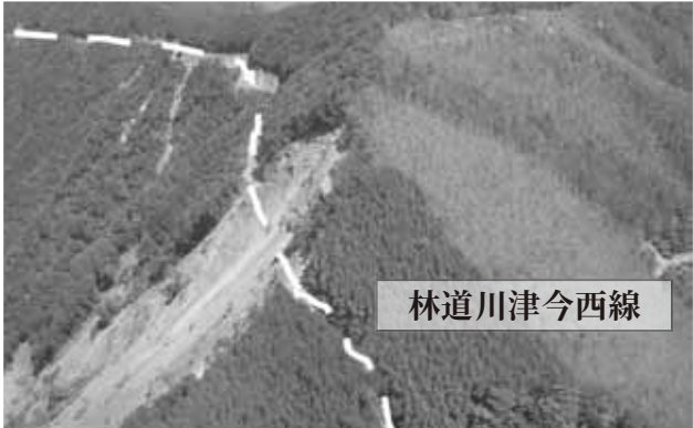
写真 54 平成 23 年 9 月 9 日 林道川津今西線の崩壊（十津川村今西地区）
