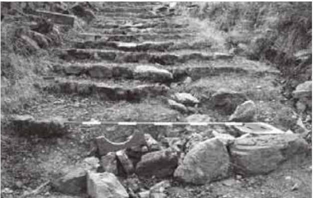
写真 70 大峰山寺階段破損状況
